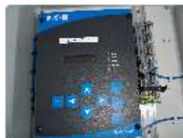
Monitorowanie instalacji 6kV
